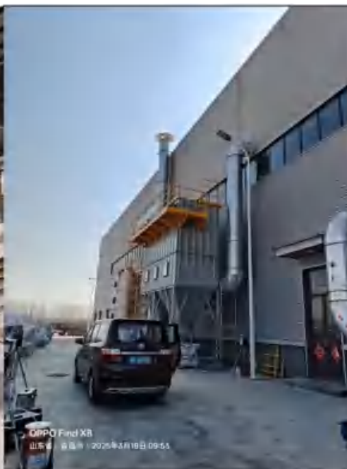
布袋除尘器及排气筒P2 (DA002)
