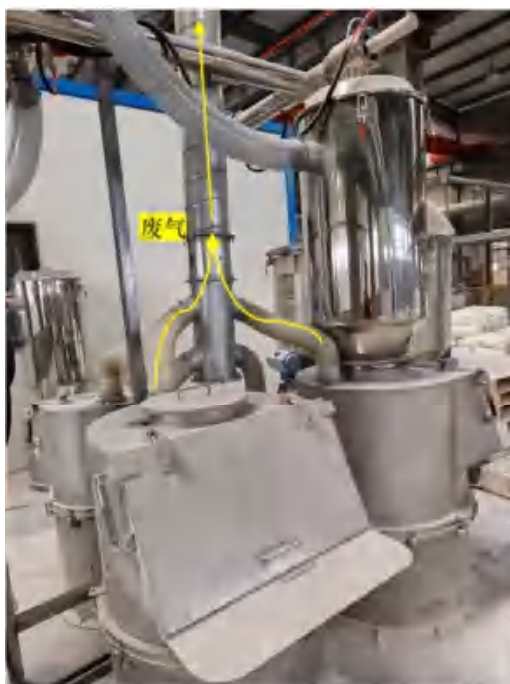
挤出线投料粉尘负压收集管道
